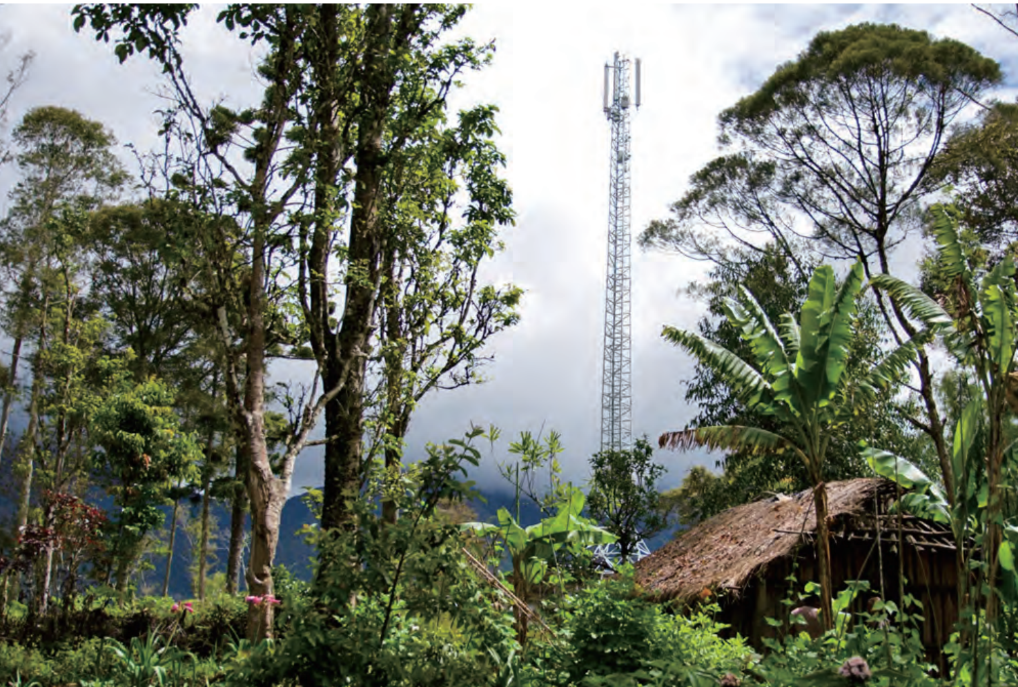
巴布亚新几内亚山区新安装的系统利用太阳能解决方案实现手机信号覆盖。
