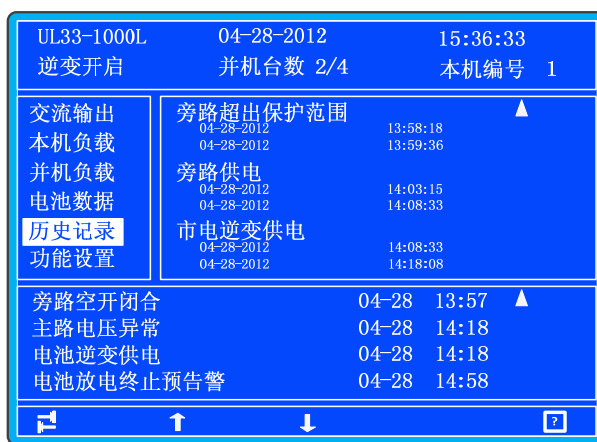
图5-18 历史记录显示屏
